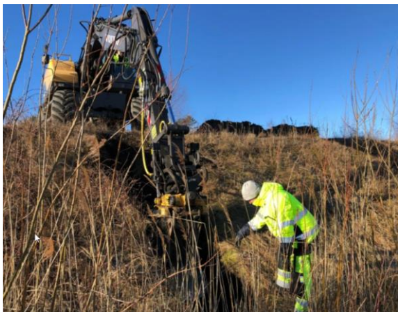
Figur 19. Provtagning med grävmaskin vid provpunkten PG2206. Bildkälla Sweco Sverige AB.
