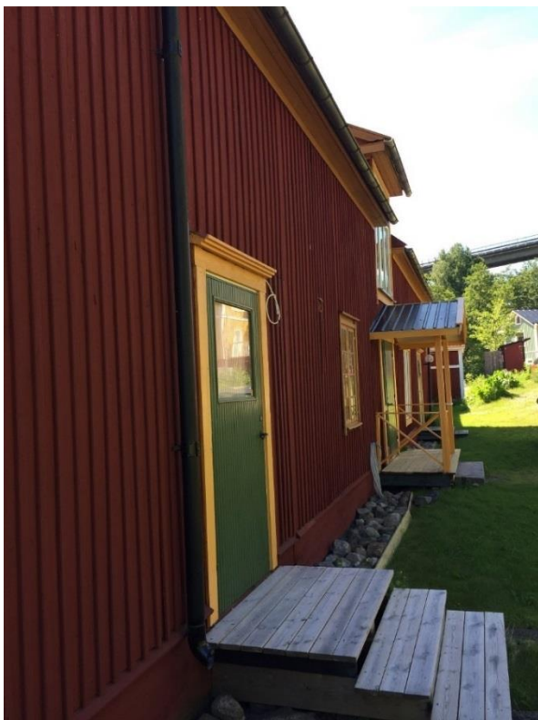
Dagvatten som leds via stuprör ut i stensamling.
