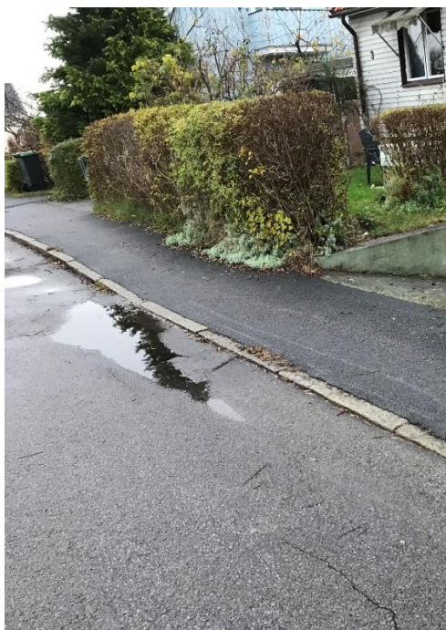
Figur 14. Vy tagen sydöst längs med Svängatan. På bilden syns stående vatten i lågpunkt mittför nedsänkt garagenedfart och nedsänkt kantsten vid fastighet som kan riskera att drabbas vid skyfall.
