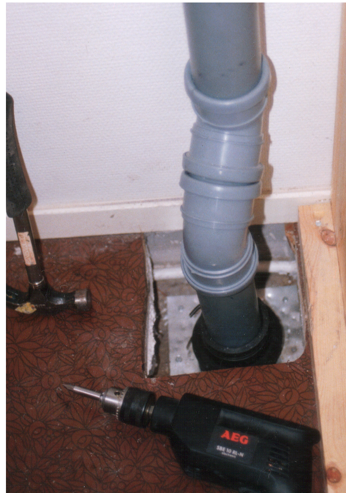
Att installera en radonsug behöver varken vara svårt eller dyrt.
