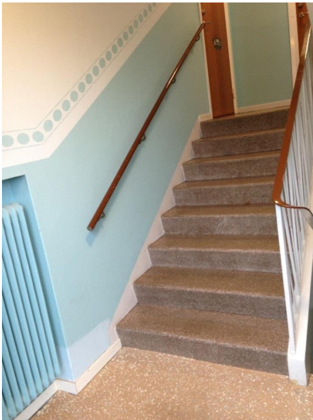
En vanlig syn i trapphusen, ingen kontrastmarkering
