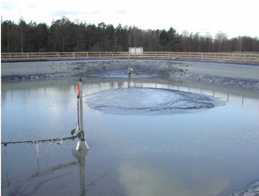
En buffertbassäng på ca 3000 m 3 byggdes för att kunna hålla ett högt tempo i avvattningen.
