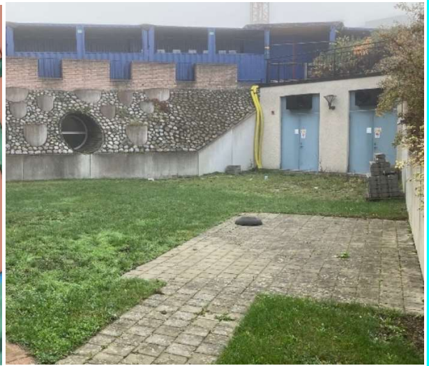
Foto: Lågmarkszonen invid ställverk utgör risk vid skyfall Bilden är tagen från Hus 20 i riktning byggnation Nyps N
