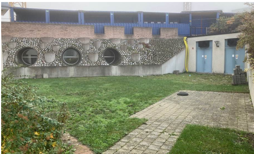
Foto: Vid Hus 20 mot sydväst. Innesluten lågt liggande markzon invid ställverk, risk vid skyfall
