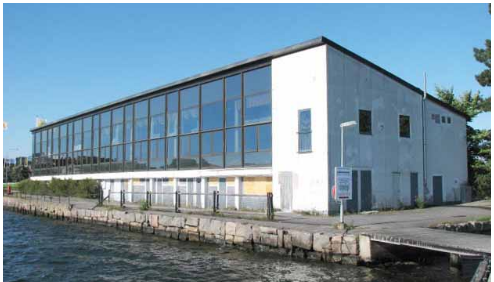
Fig 33. Byggnaden i september 2010. Förfallet är påtagligt.
